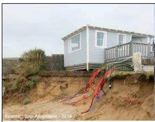
Erosion marine prononcée de la dune (au droit du camping), lors des tempêtes de 2013-2014.
