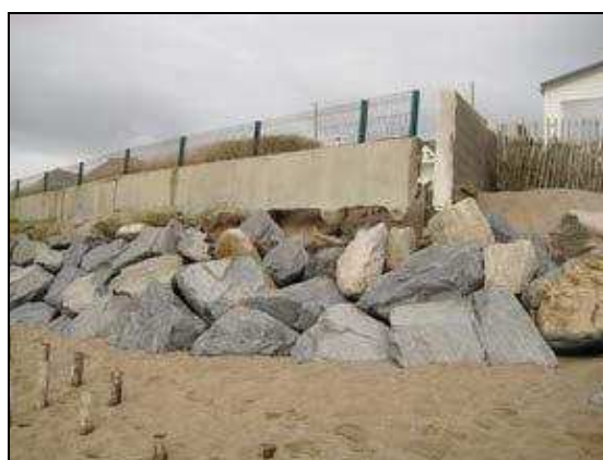
Destruction par la houle de tempête du mur de clôture de la parcelle privée n° 128.
