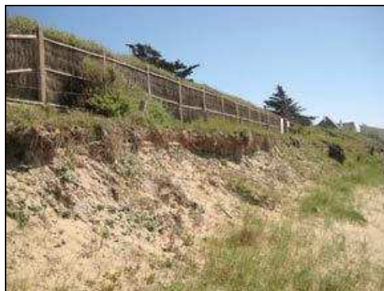
Erosion de la falaise par la houle de tempête et fragilité du sentier littoral situé en crête.
